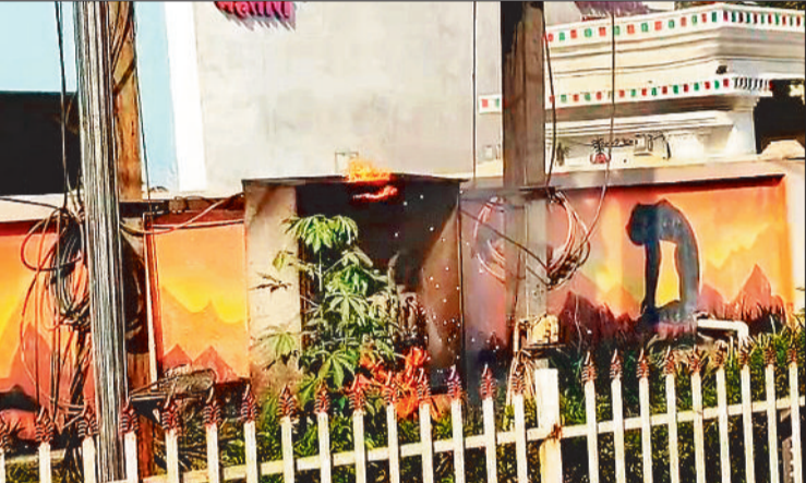
गर्मी की दस्तक के साथ ही बिजली का लोड अचानक बढ़ चुका है। हाल के 5 दिनों में 18 फीसदी लोड बढ़त देखी जा रही है। इसका असर ट्रांसफार्मर पर भी पड़ने लगा है, यही कारण है कि रोजाना डियो गिरने और केबल चलने की शिकायत विभाग को मिल रही है।
